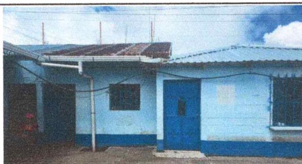
Foto 5: Pintura en muro exterior en módulo de aulas 4, 5 y 6, por deterioro
