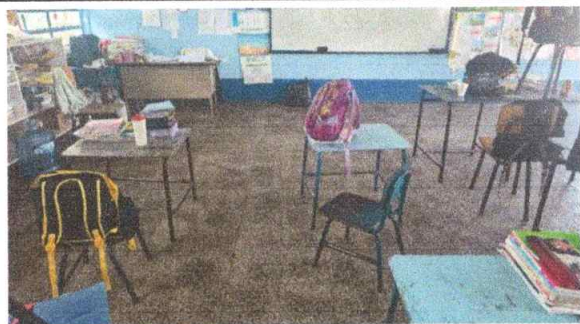
Foto1: Sustitución de piso de granito por piso cerámico en módulo de aulas, requiere de cambio de piso por deterioro en aula 1
